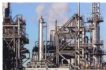
プラント/設備
