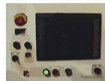
操作パネル(HMI)
